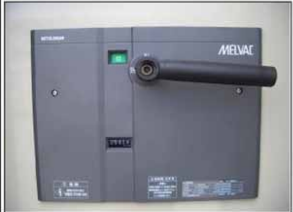
真空遮断器 (VCB)
