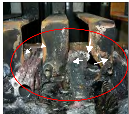
焼損MCCB電源側拡大
