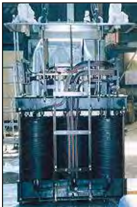
劣化変圧器内部
