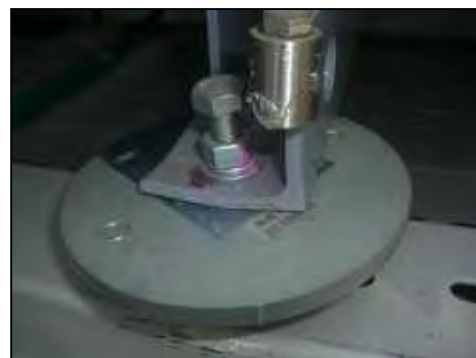
45度近く回転してしまった防振ゴム
