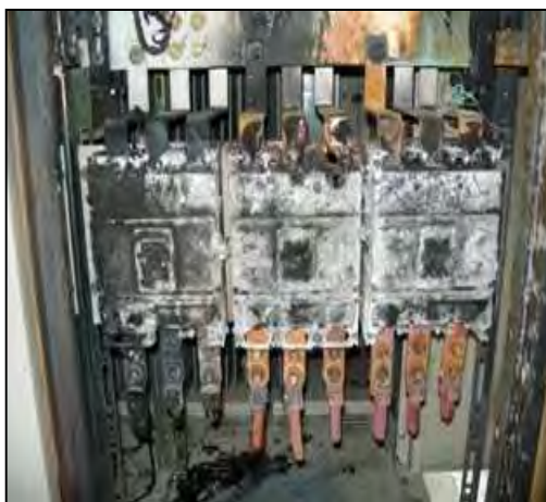
焼損MCCB部拡大
