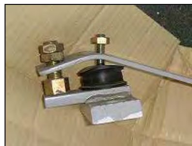
変形した防振ゴム部分
