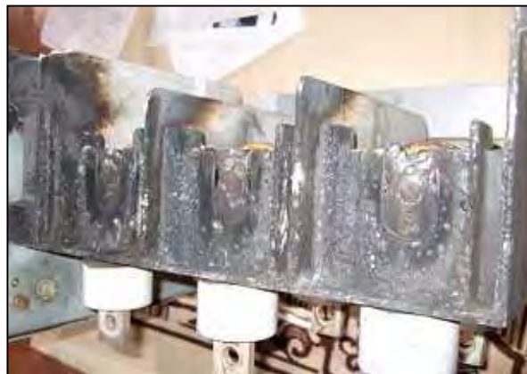
焼損したVCB(本体側面)
